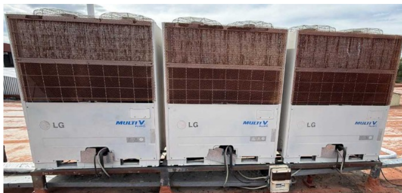
Imagen de los equipos a desinstalar
